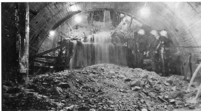
大量の土砂が噴き出す破砕帯現場
