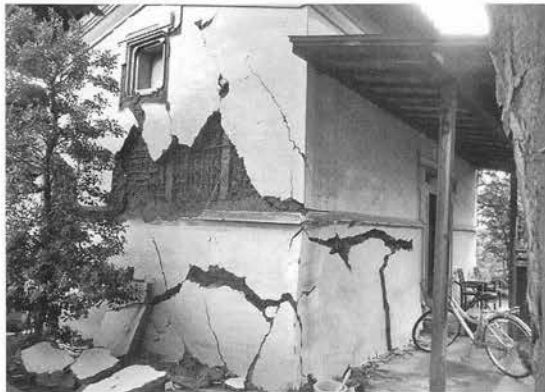
写真1 崩壊した漆喰の蔵壁(並柳地区)
