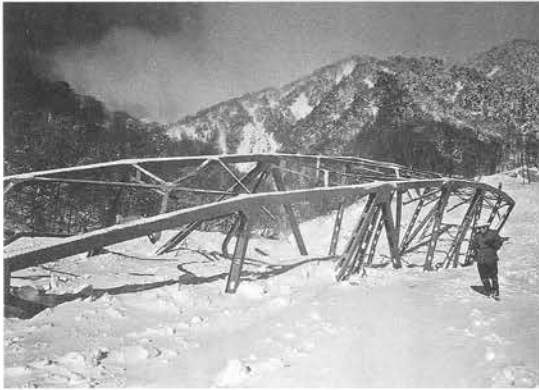
写真5 大町ルート扇沢鉄橋 表層雪崩により100m下流へ吹飛ぶ 昭和36年1月27日
