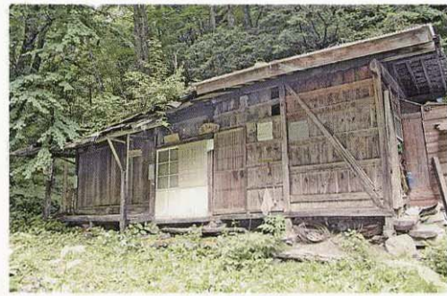
写真3 岩魚留小屋 (2008年)
